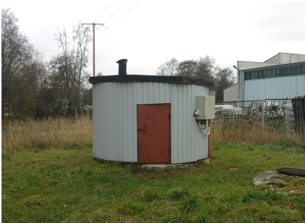
Joonis 12. Kiiu kanalisatsiooni ülepumppla
